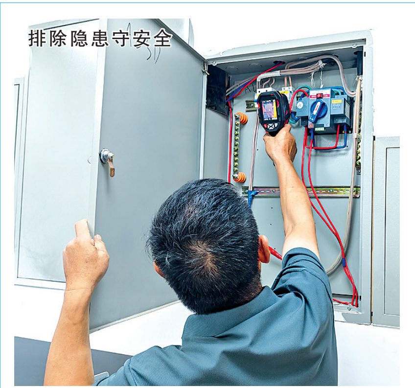
日前，中国银行三门峡分行组织安保条线、信科条线到中行灵宝支行开展安全生产检查，重点检查设备间、办公区等区域的消防设施和安防情况。全行各营业网点认真落实“经纬线”工程要求，抓好网络安全管理，认真排查安全隐患，严防各类安全事件。 王为民 摄
