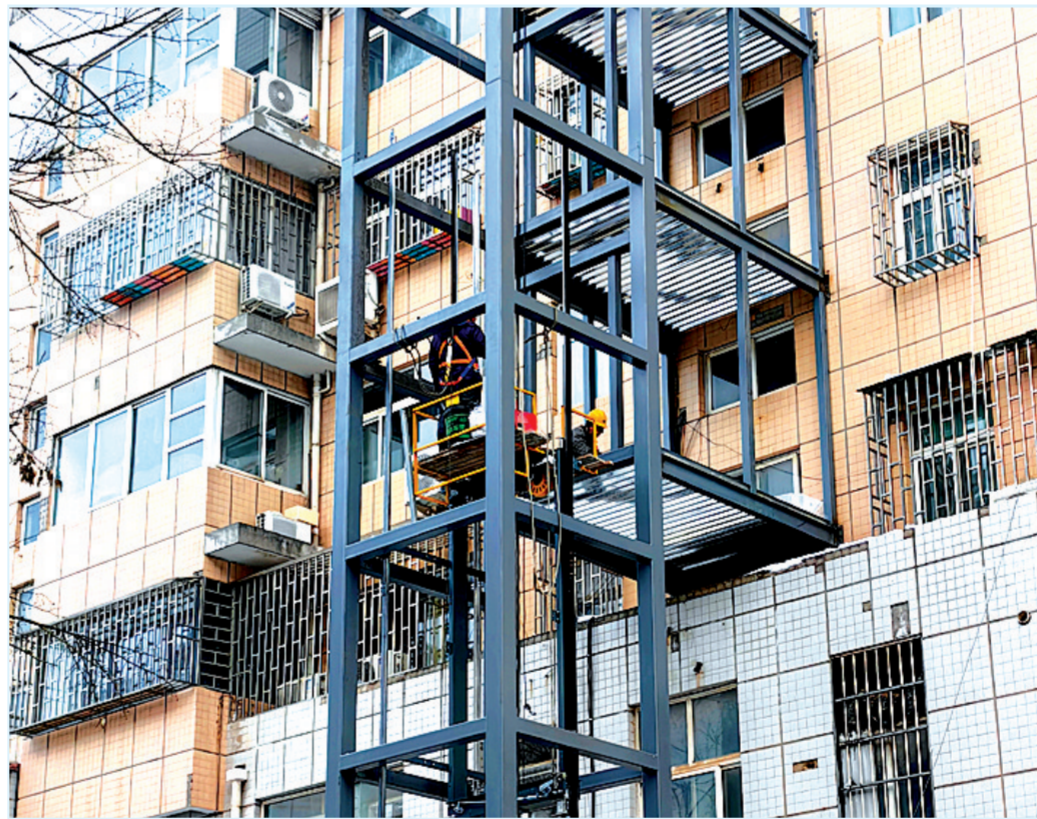
1月21日,渑池县韶阳街道黄河社区一小区临街楼栋前,电梯加装工程正在紧张推进。工人们紧锣密鼓赶工期,确保电梯在春节前投入使用,让居民过上“上下无忧”的暖心年。 王家臣 摄
