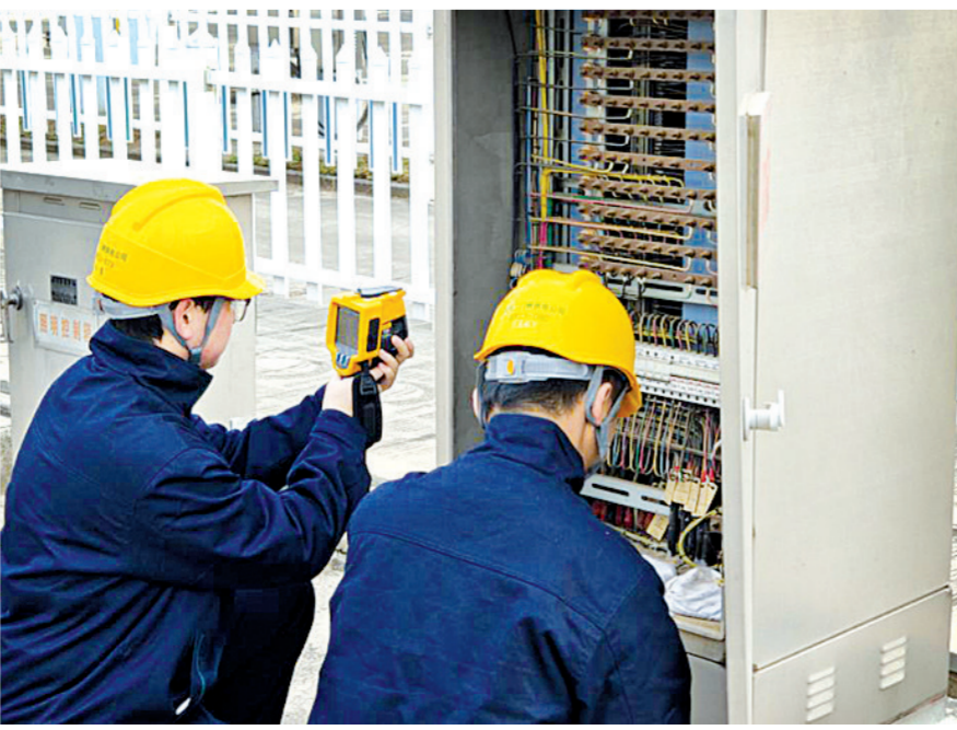
供电人员开展设备巡视。鲍泽宏 摄
