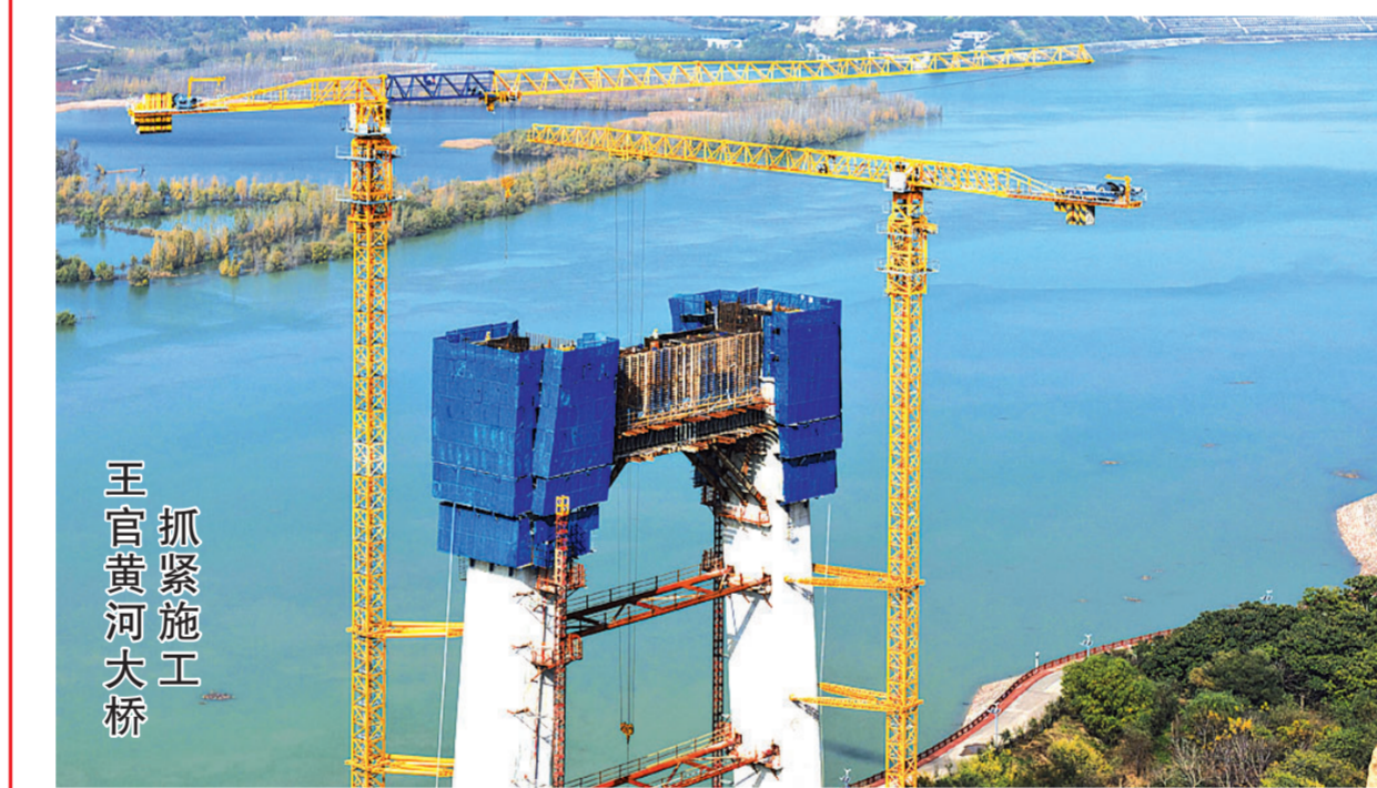
11月9日,国道209王官黄河大桥建设工地一派繁忙景象,施工人员正在对主塔塔柱进行混凝土浇筑作业。据了解,王官黄河大桥是连接河南省三门峡市与山西省平陆县的跨黄河战略通道,全长16.73公里,主桥为双塔双索面斜拉桥,大桥主跨450米,桥宽31.5米。
