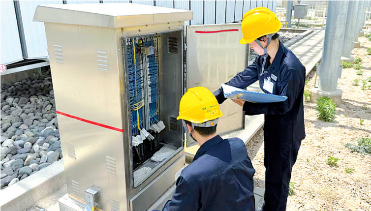
工作人员正在对220千伏甘棠变电站进行防汛隐患排查
