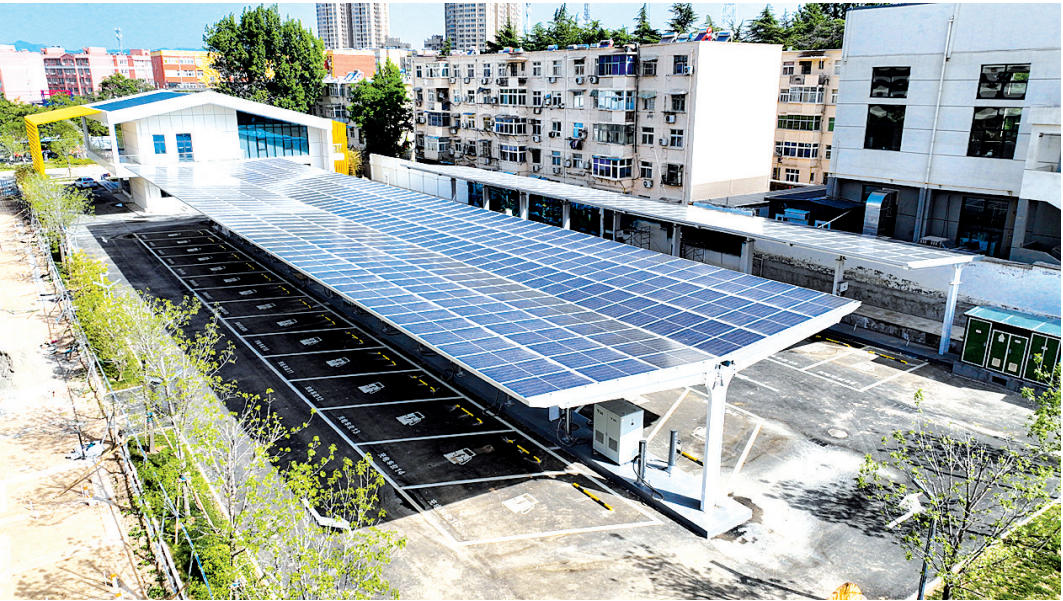
光储充放检智慧微网充电站全貌。
