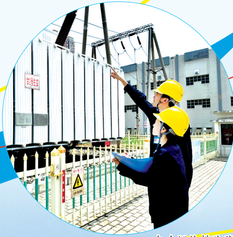
电力巡检排除隐患 李聪 摄
