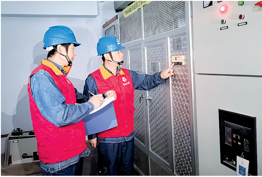
4月29日,国网三门峡供电公司工作人员到职工学校小区对配电箱进行巡视测温 and 隐患排查。
