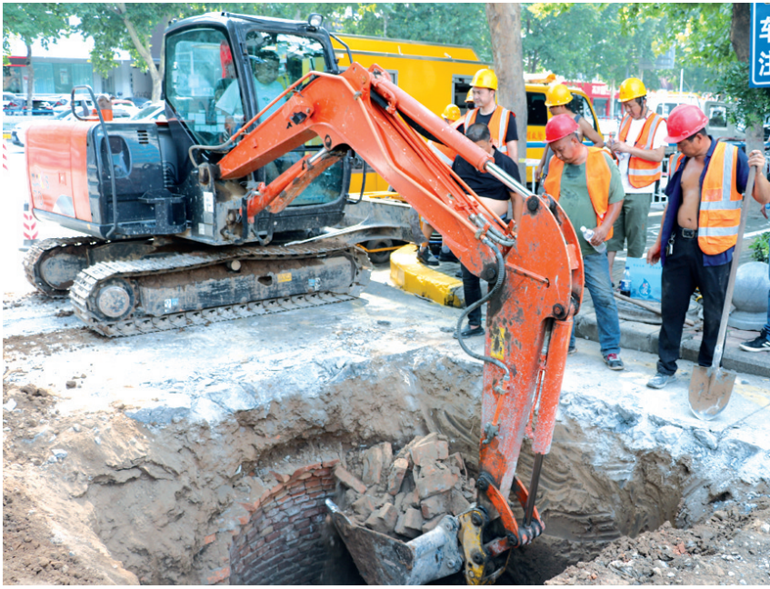
由于7月24日突降暴雨,25日市供水集团安排工作人员对积水路段供水管道进行巡查,发现崤山路金渠集团门口DN350供水管道破裂,影响部分区域供水。该公司及时组织人员进行抢修,于25日下午恢复正常供水。图为抢修现场。
