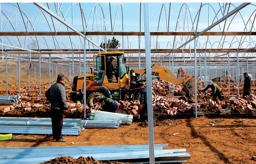
1月20日,陕州区观音堂镇窑院村新建烟叶育苗工场项目施工现场。本报记者 王建栋 摄
