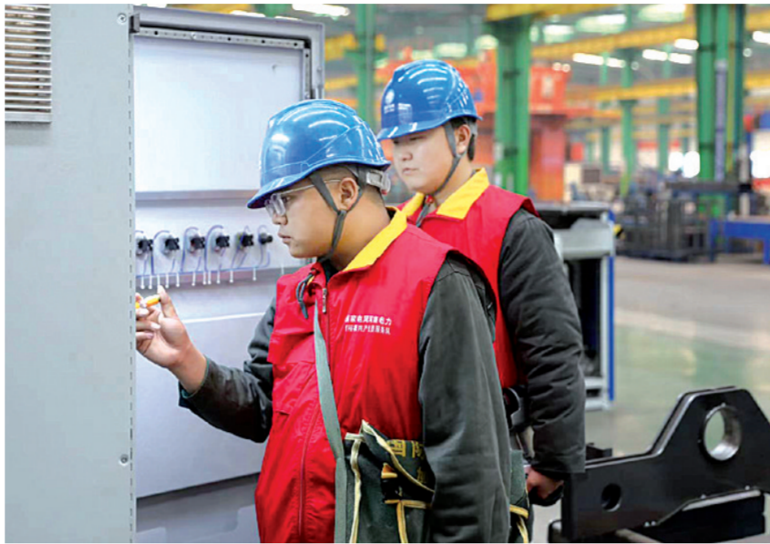
检查供电设备运行情况
