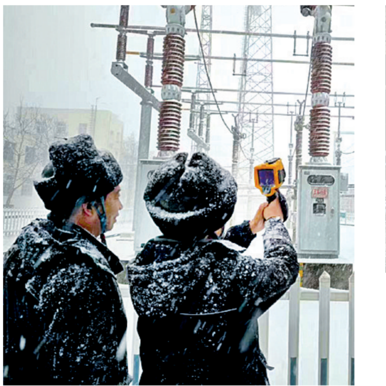
↑1月15日,国网三门峡供电公司启动预警和应急机制,加强电网科学调控,做好设备特巡特护,及时准确处置电网突发情况,全力确保地区电网安全稳定运行。图为工作人员对电网设备开展巡视测温。 本报记者 梁媛 通讯员 马翔飞 摄
