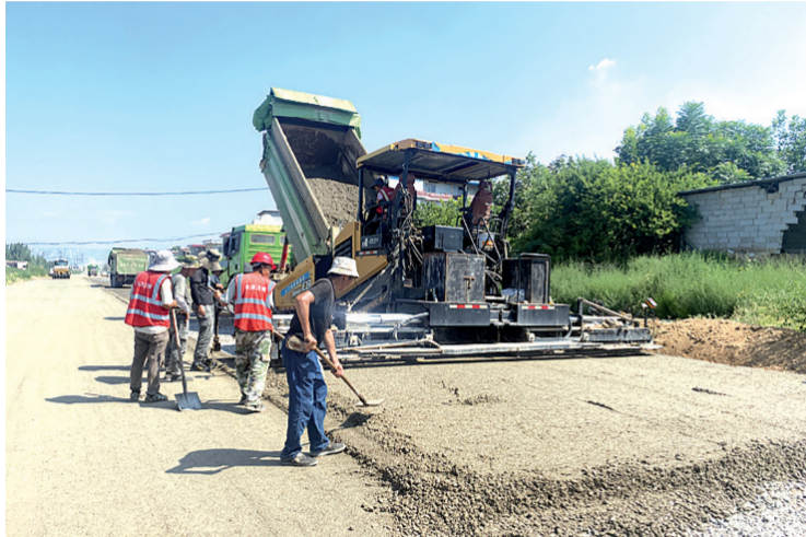
八月四日,市城乡一体化示范区周公路、滨河道路建设正在施工,正在进行水泥路、路侧绿化带等工程,张荣华摄。
